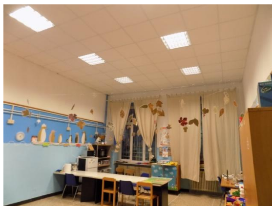
Figura 4.17 - Particolare dei corpi illuminanti ubicati nelle aule
