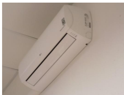
Figura 4.16 - Particolare del sistema monosplit
