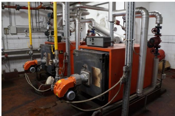
Figura 4.12 - Particolare dei generatori di calore presenti all'interno della CT
