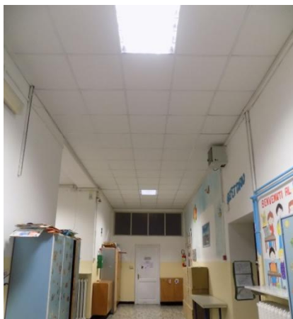
Figura 4.18 - Particolare dei corpi illuminanti ubicati in una zona di circolazione
