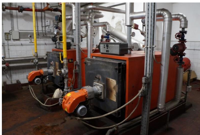
Figura 8.3 – Particolare generatori di calore
