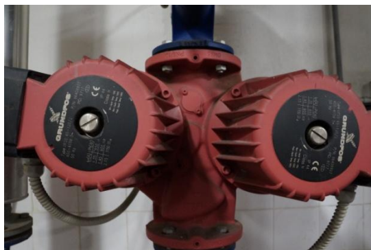
Figura 8.7 – Particolare pompe di circolazione
