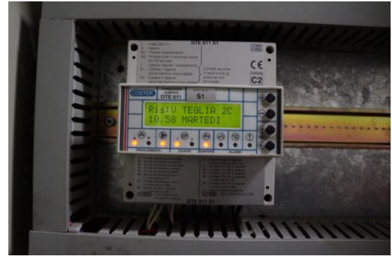
Figura 4.9 - Particolare della centralina di controllo in centrale termica
